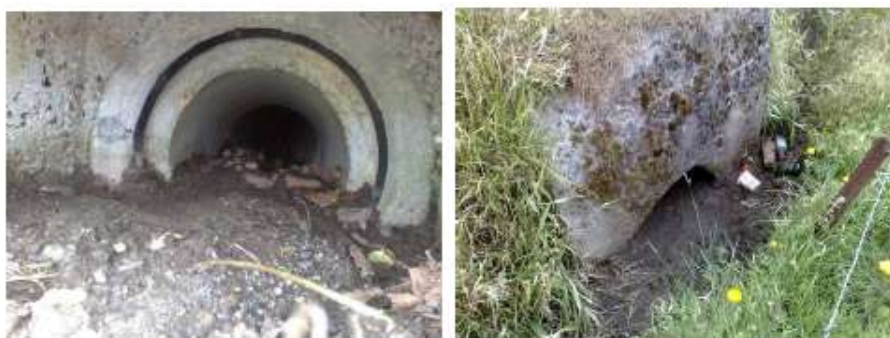
Exemple de réseaux encombrés sur le territoire de Longueil
